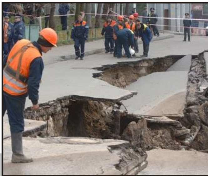
Провал грунта в районе Трубной площади в Москве, апрель 2007 г.
